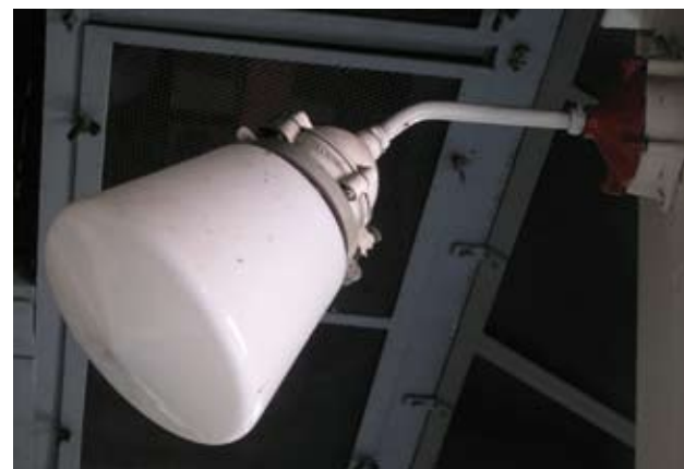
Gebe-armatur från Sieverts Kabelverk. Relativt vanligt förekommande kapslad industri-belysning från 1940-talet.
